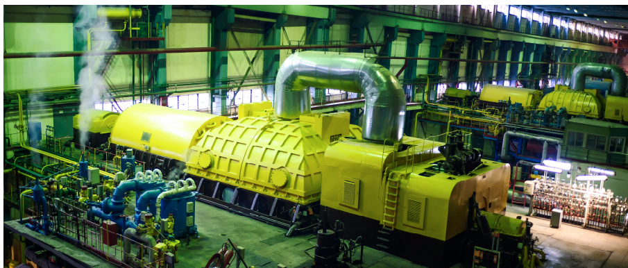
Рис. 3 – Турбоагрегат энергоблока ст.№5 Березовской ГРЭС
