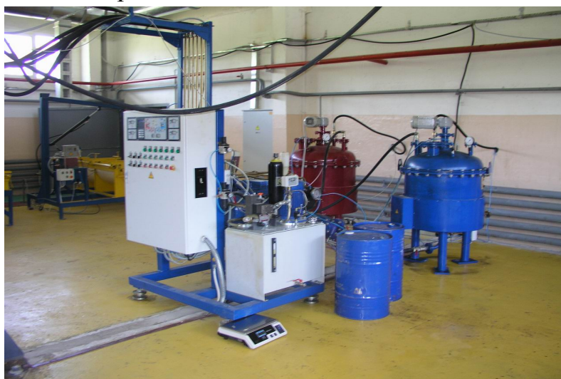
Рисунок 1 – Смесительно-дозировочная установка высокого давления
