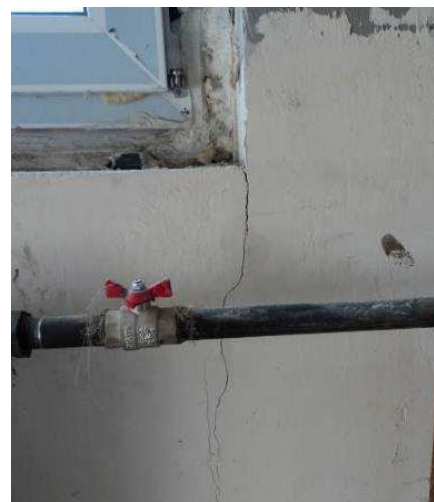
Рисунок 3 – Характер трещинообразования в заполнении с оконным проемом при усадке каменной кладки
