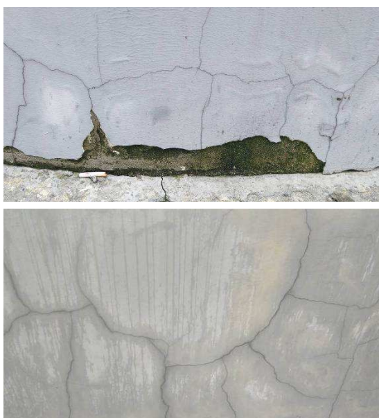
Рисунок 3 – Дефекты штукатурного покрытия цоколя
