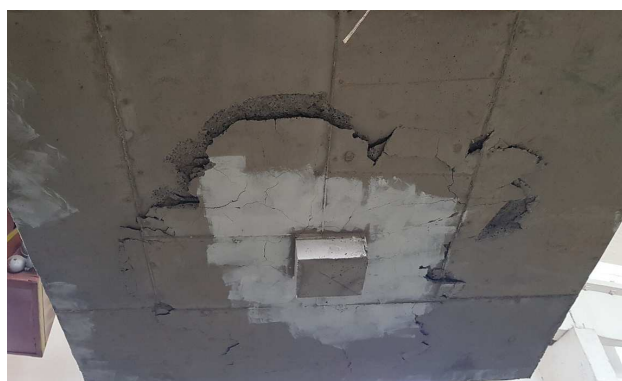
Рисунок 15 – Характерная картина разрушения плит ПН VII-12 и ПН VIII-12, армированных сетками \varnothing 12S500
