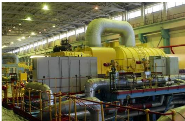
Берёзовская ГРЭС - турбины
