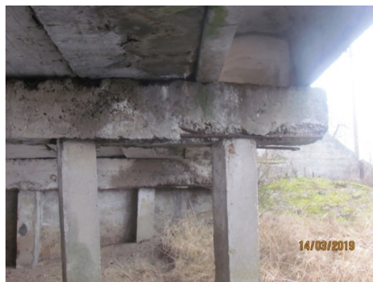
Рисунок 4 – Деструкция бетона насадок, коррозия и выключение арматуры из работы
