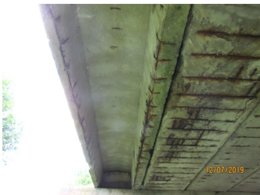
Рисунок 5 – Замокание и размораживание бетона плит, коррозия арматуры
