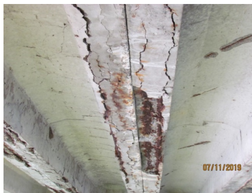
Рисунок 6 – Продольные коррозионные трещины в рёбрах П-образных плит
