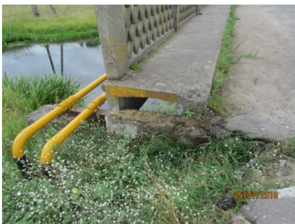
Рисунок 1 – Отсутствует сопряжение подходов с тротуарами
