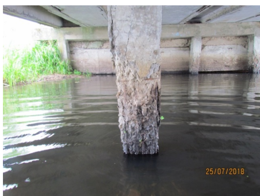
Рисунок 3 – Размораживание бетона свай, коррозия арматуры
