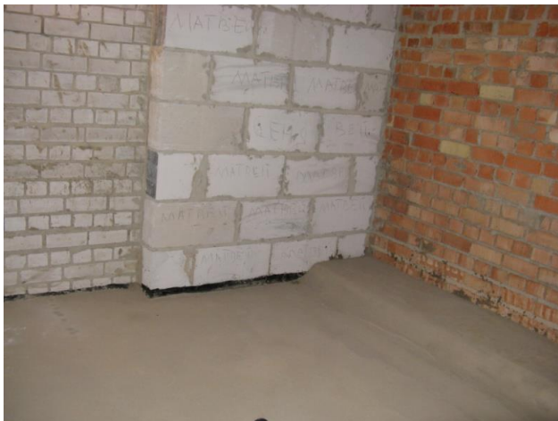
Рис. 4. Недостаточное утепление вентиляционных каналов
