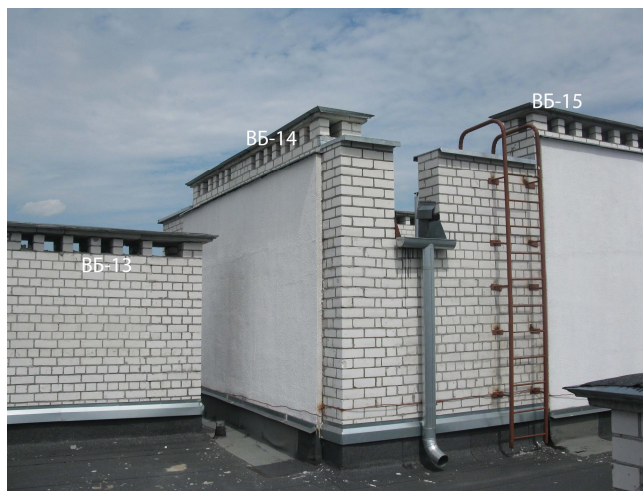
Рис. 3. Устья вентиляционных каналов в зоне ветрового подпора
