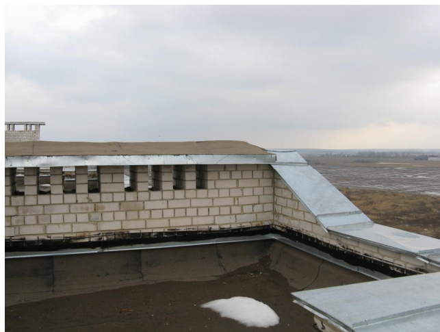
Рис. 2. Занижение отметки устья вентиляционных каналов
