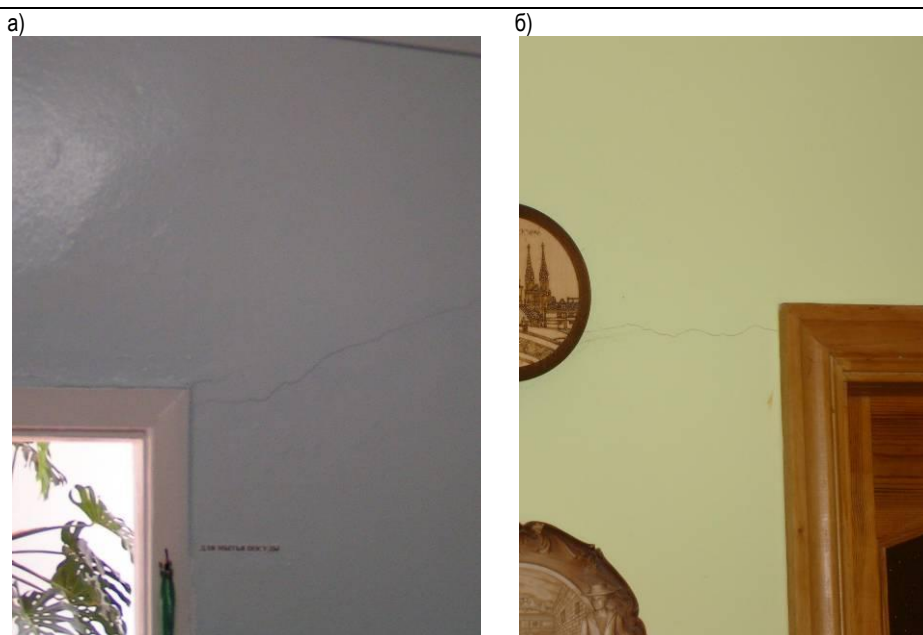
Рис. 4. Характер образования трещин в перегородках с дверными проемами а) наклонная трещина при одном проеме; б) горизонтальная трещина между двумя проемами
