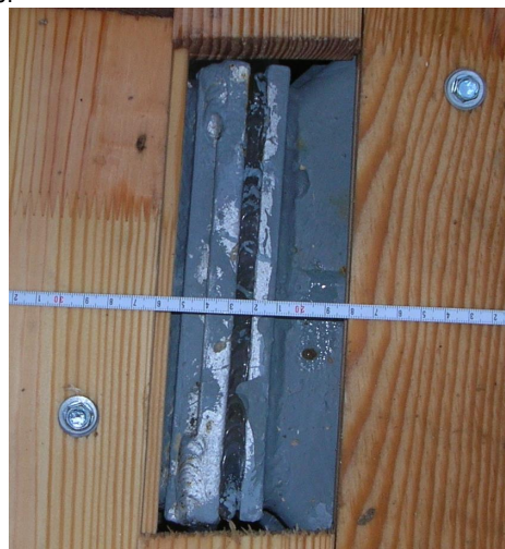
Рис. 2. Дефекты монтажа узлов верхней поясной сетки структурной оболочки (раскрытие фланцев)
