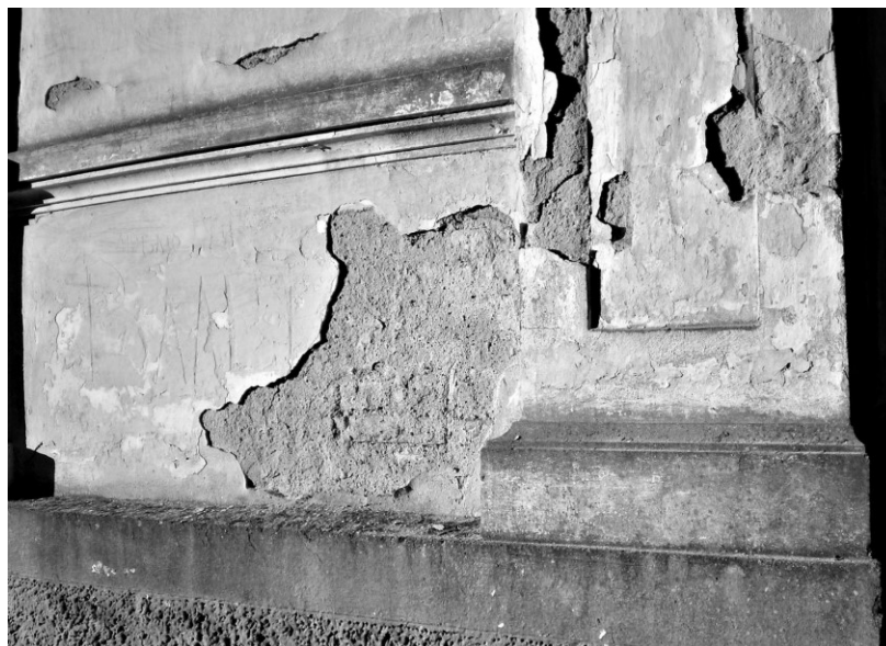
Фото 1 – Штукатурка, отколовшаяся от цоколя здания вследствие кристаллизации солей (пример коррозионного действия капиллярно поднимающейся влаги в сочетании с сильными высолами)
