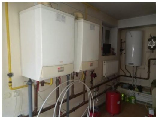
а) котельная 100 кВт;
