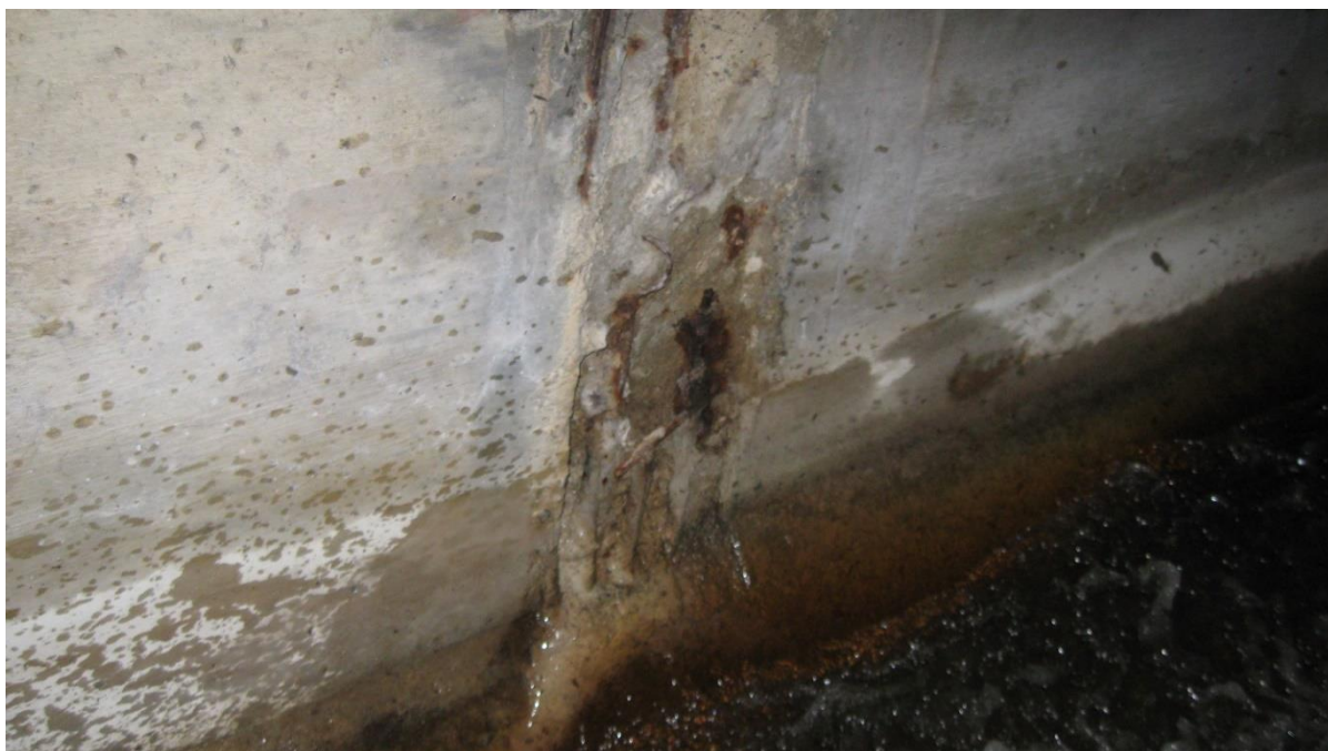
Рисунок 3 – Стык железобетонных труб, выполненный из монолитного бетона в тоннеле ковшового водосброса (водохранилище Кутовщина Барановичского района Брестской области, 2023 г.)
