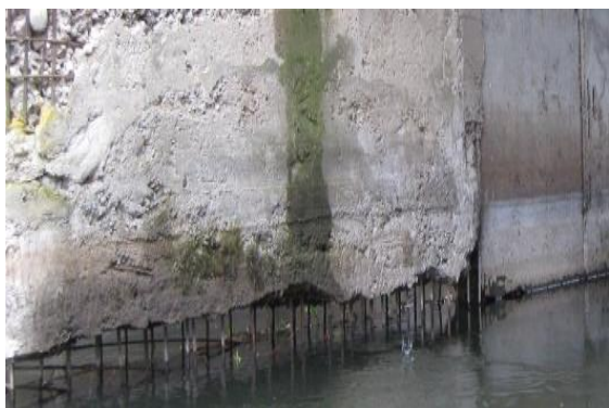
Рисунок 1 – Разрушение конструкции разделительного быка на р. Уша Минской области (2008 г.)
