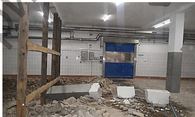
Рисунок 1 – Обрушение колонны в прессовом цехе
