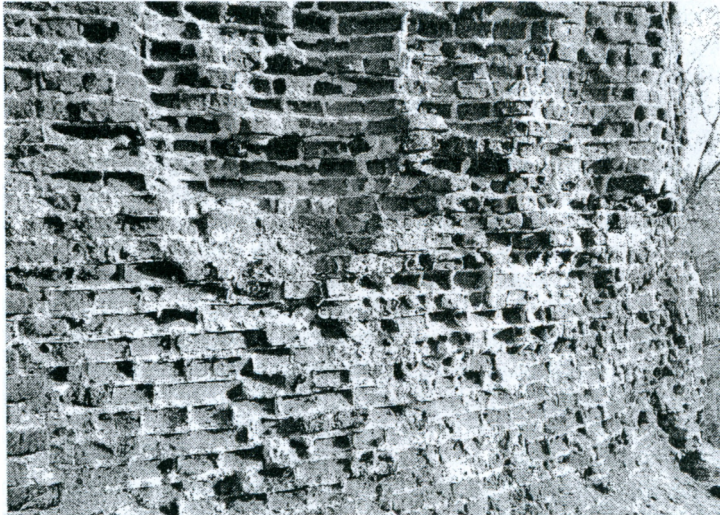
Фото 3,4. Примеры сильного коррозионного разрушения кирпичной кладки вследствие сильного увлажнения и засоленности
