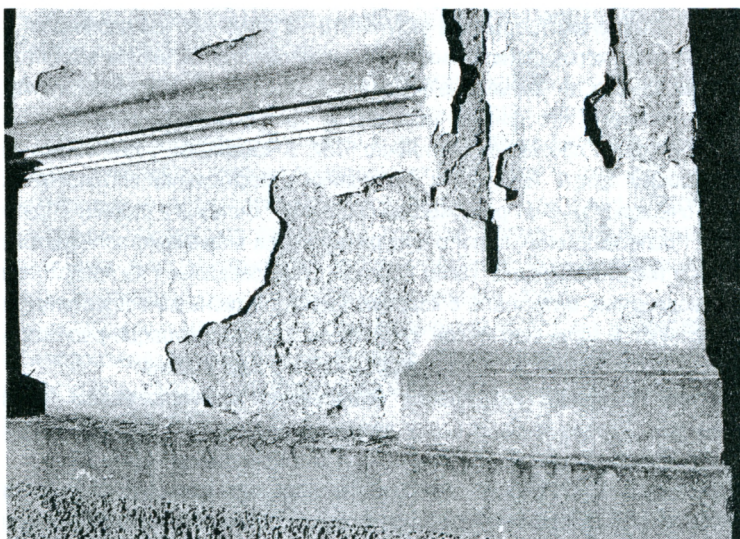
Фото 1,2. Штукатурка, отколовшаяся от цоколя здания вследствие кристаллизации солей (пример коррозионного действия капиллярно поднимающейся влаги в сочетании с сильными высолами)
