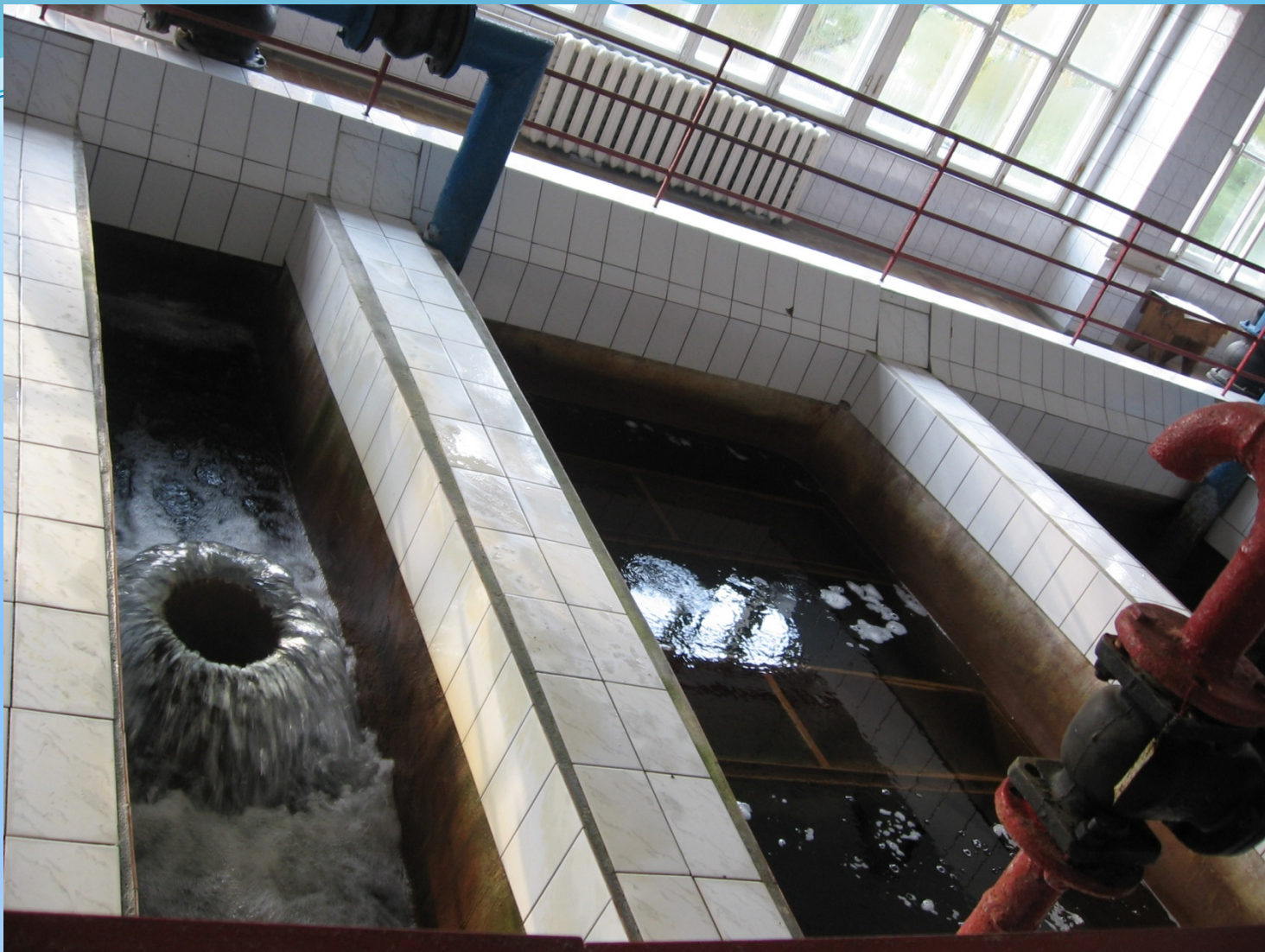
Рисунок 6 - Фильтр обезжелезивания Граевского водозабора
