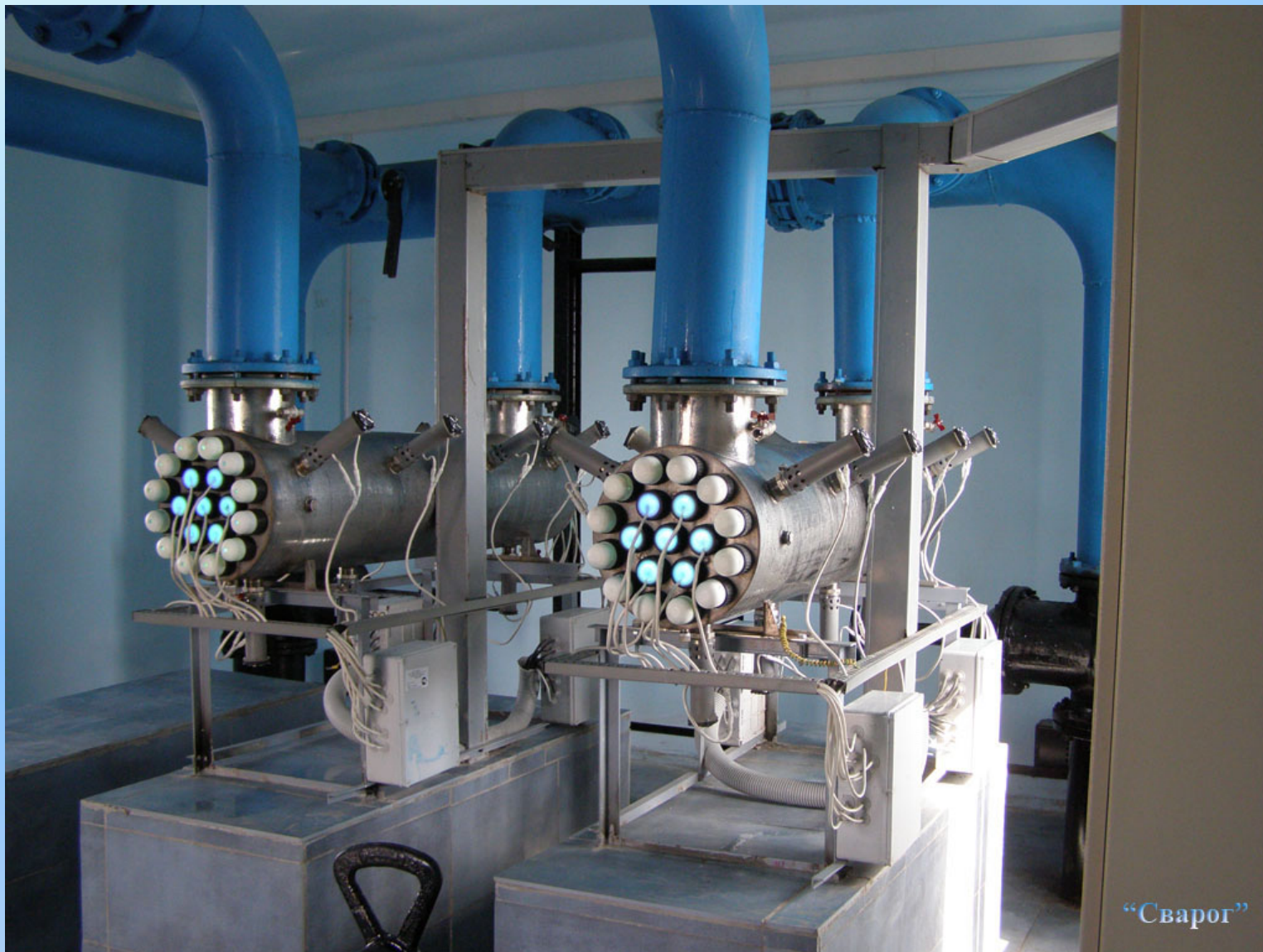
Рисунок 11 – Станция обеззараживания воды УФ-лучами
