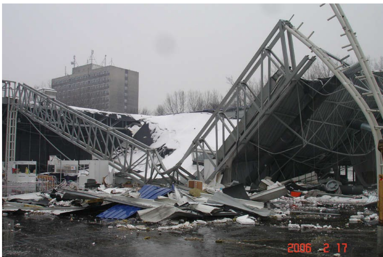
Рисунок 2 – Обрушение крыши выставочного зала г. Катовице, Польша [3]
