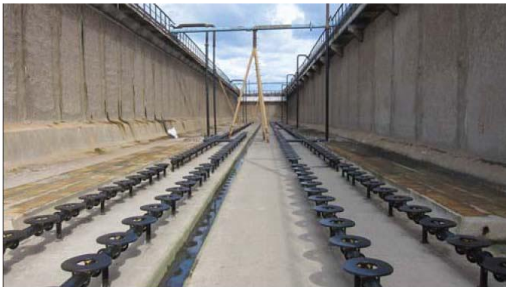
Рисунок 1- Аэраторы АКВА-ТОР в аэротенках на Люберецких очистных сооружениях АО «Мосводоканал» [9]
