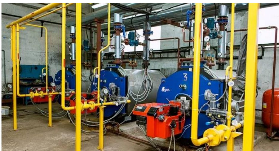
Рисунок 1 – Котельная на газообразном топливе
