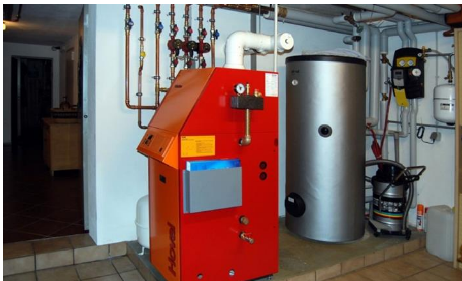
Рисунок 2 – Котельная на жидком топливе
