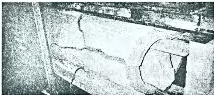
Рисунок 2 – Характер разрушения бетонной трубы
