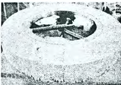
Рисунок 6 – Разрушение бетонного кольца
