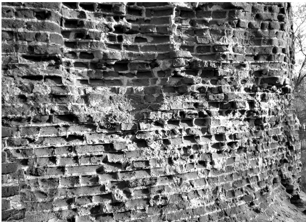
Рис. 3. Коррозионное разрушение кирпичной кладки вследствие сильного увлажнения и засоленности.
