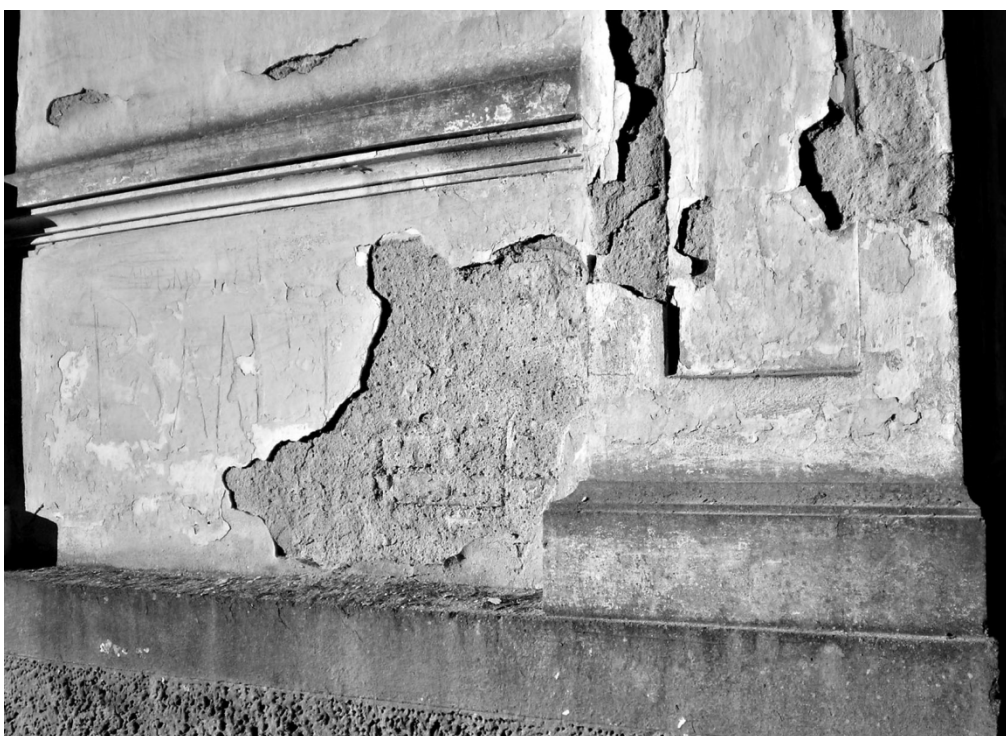
Рис. 1, 2. Штукатурка, отколовшаяся от цоколя здания вследствие кристаллизации солей (пример коррозионного действия капиллярно поднимающейся влаги в сочетании с сильными высолами).
