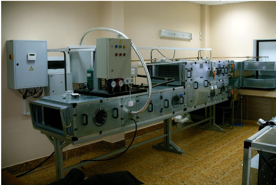
Рисунок 9 – Стенд “Центральный промышленный кондиционер”
