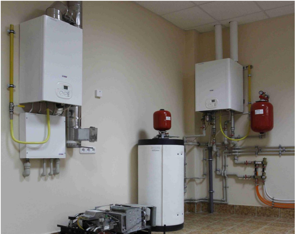
Рисунок 5 – Стенд лаборатории теплогенерирующих установок и энергосбережения с газовыми котлами
