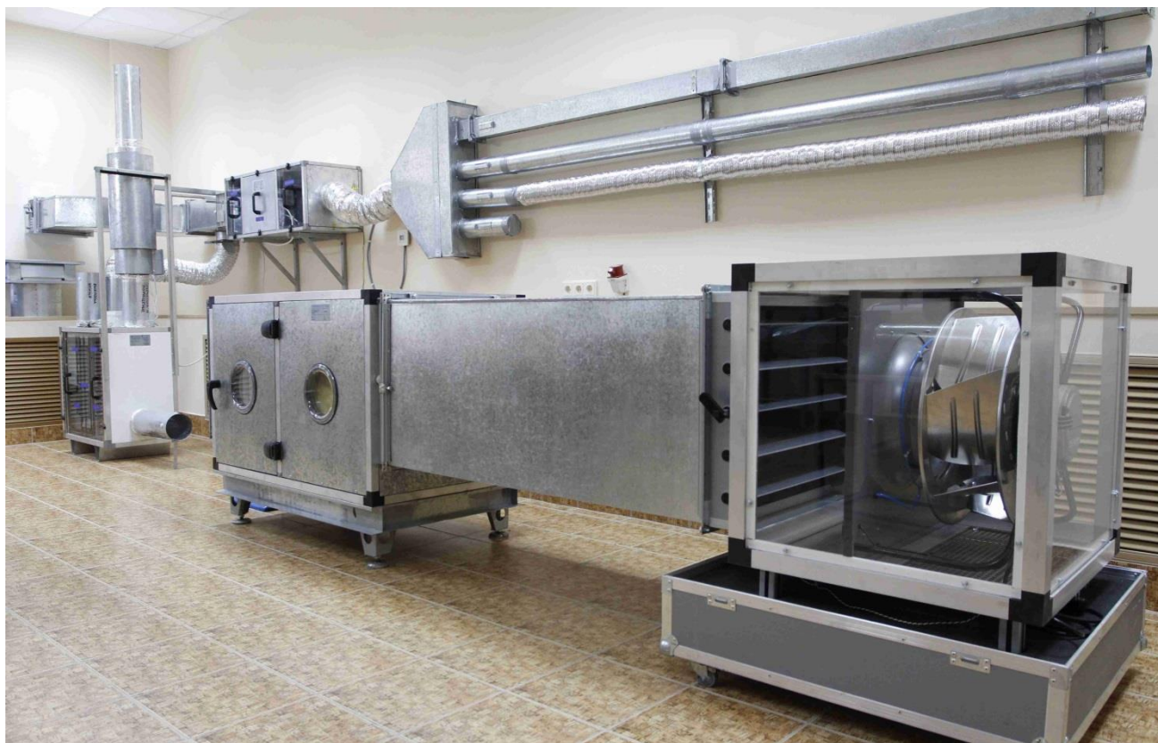
Рисунок 4 – Часть стендов лаборатории вентиляции, кондиционирования воздуха и холодоснабжения
