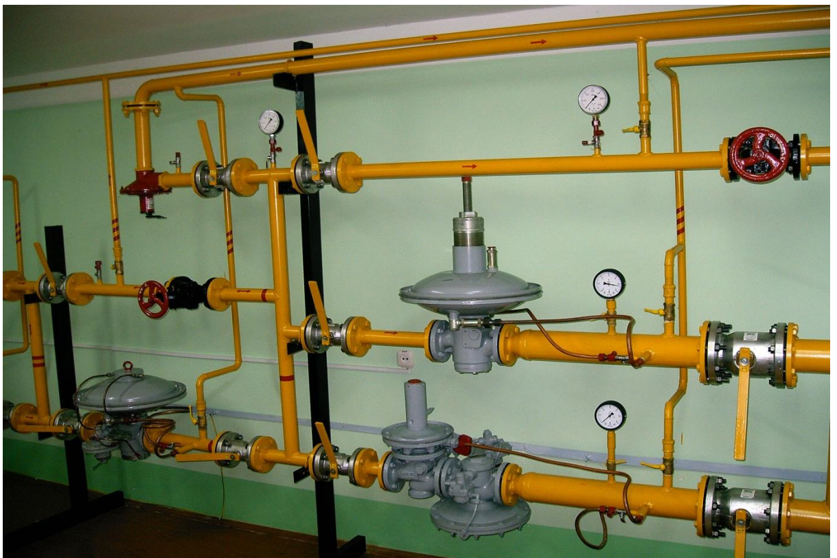
Рисунок 8 – Стенд “Газорегуляторная установка” лаборатории газоснабжение
