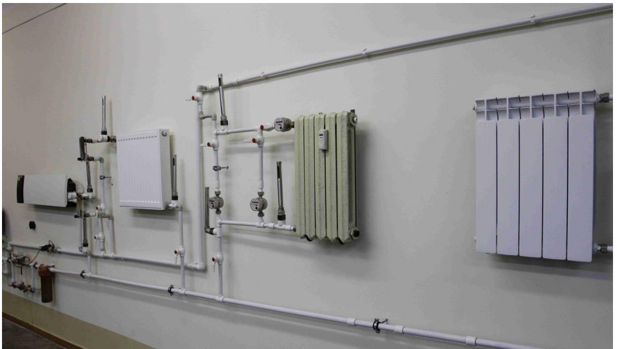
Рисунок 6 – Стенд “Система отопления” с различными отопительными приборами
