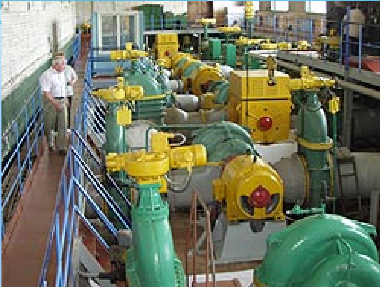
Рисунок 9 - Насосная станция второго подъема
