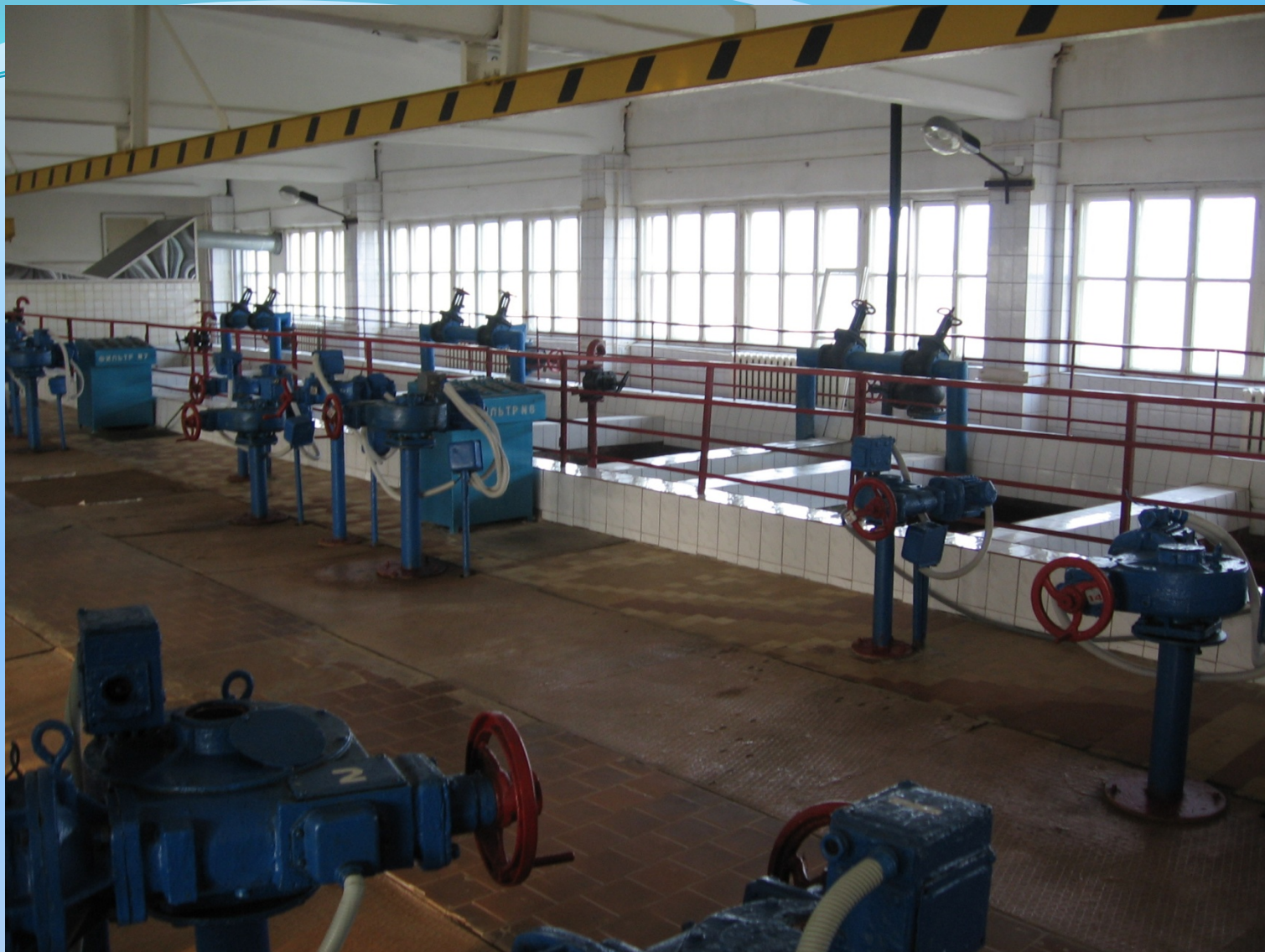
Рисунок 8 - Зал фильтров обезжелезивания Граевского водозабора
