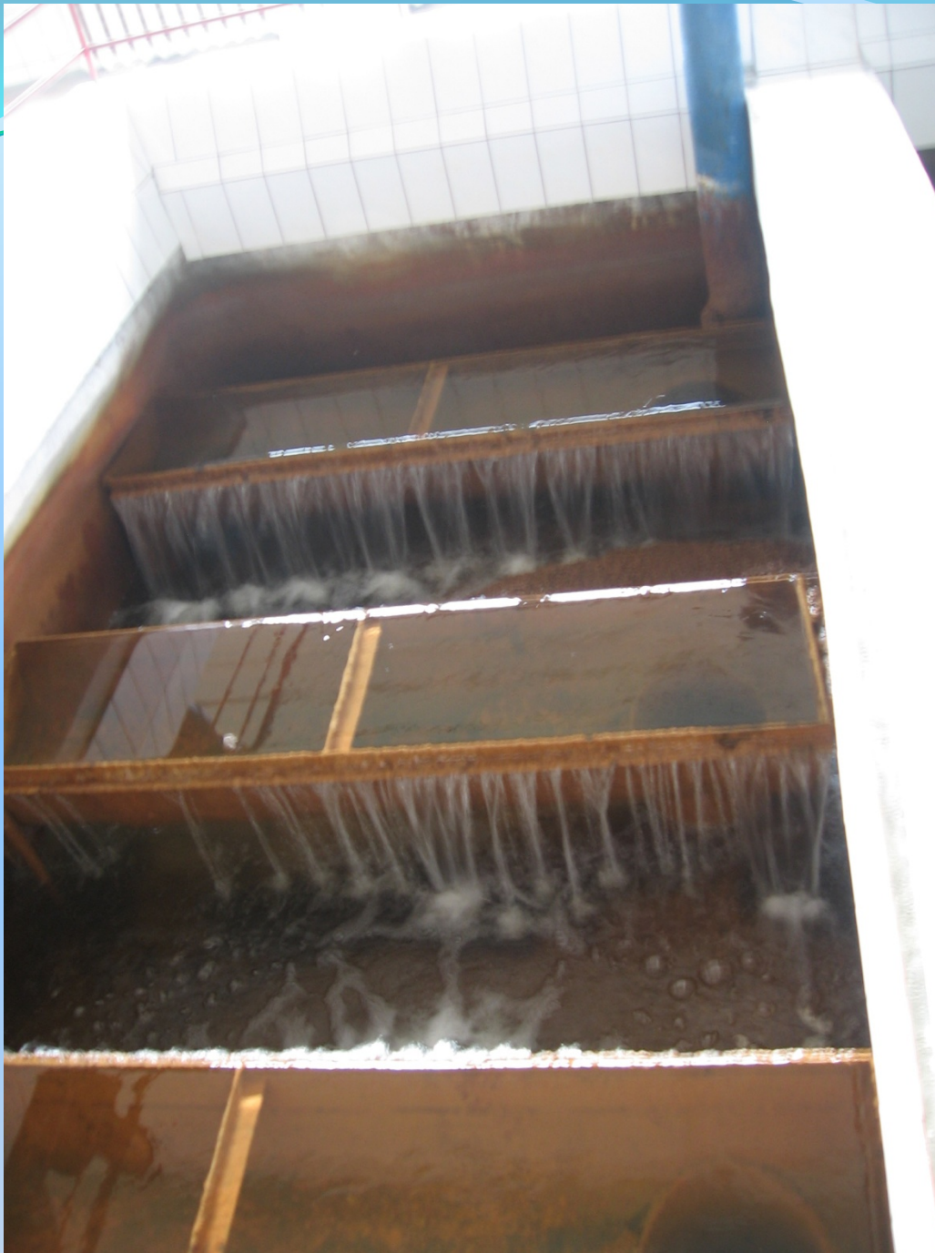
Рисунок 7 – Фильтр обезжелезивания Граевского водозабора
