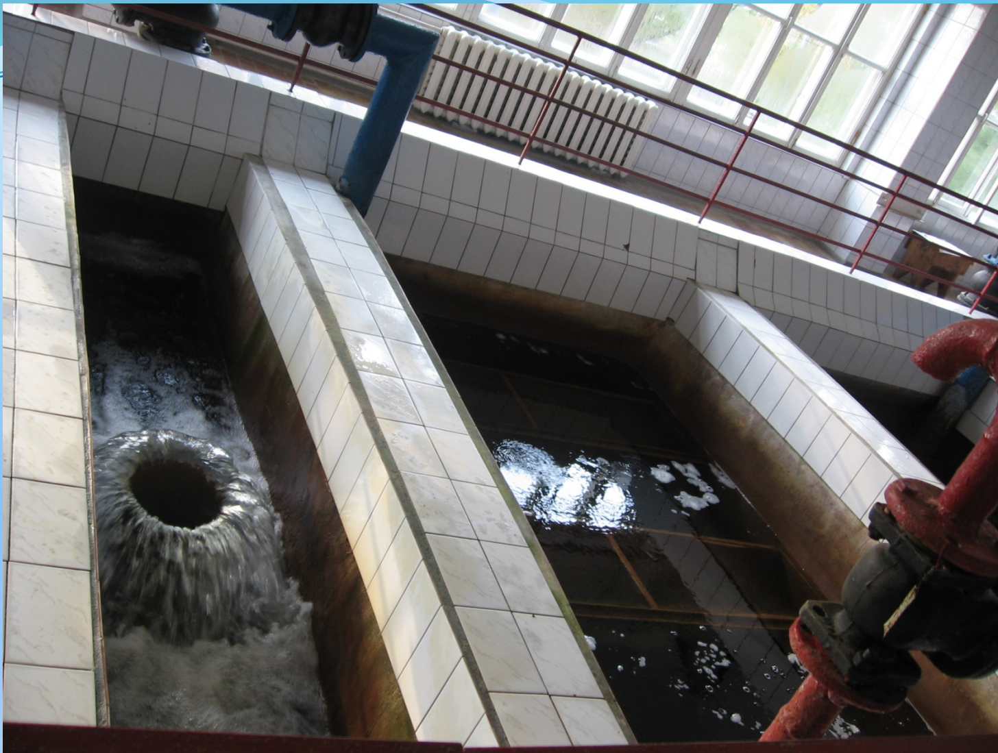
Рисунок 6 - Фильтр обезжелезивания Граевского водозабора
