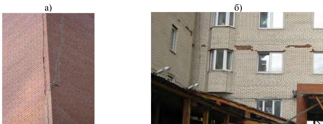
а) трещины в облицовочном слое; б) раздробление облицовочного кирпича Рисунок 2 – Характерные повреждения облицовочного слоя многослойных стен
