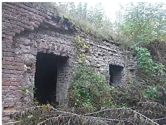
Рисунок 4 – Дефекты кирпичной кладки
