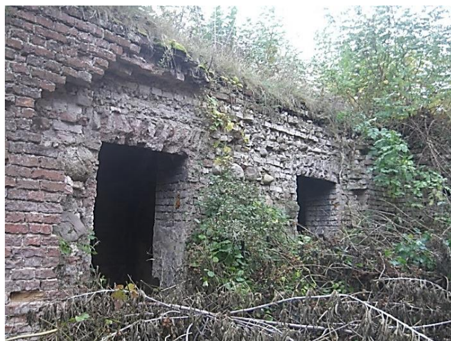
Рисунок 4 – Дефекты кирпичной кладки
