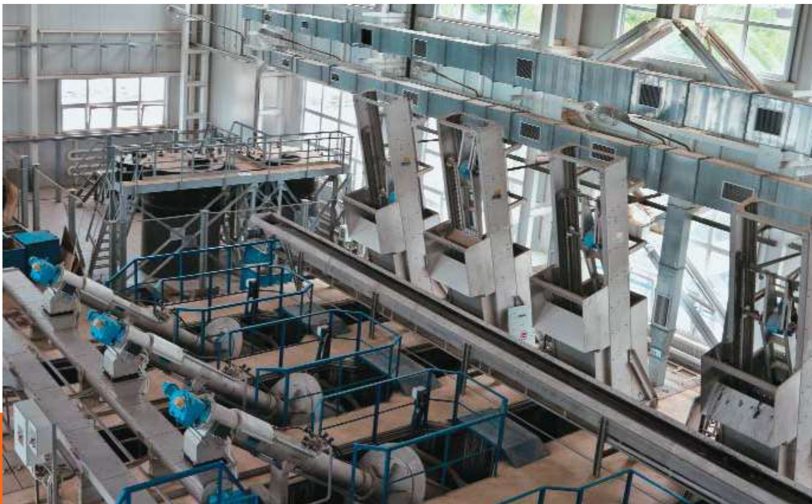
ПОСЛЕДОВАТЕЛЬНО УСТАНОВЛЕННЫЕ РЕШЕТКИ ГРУБОЙ И ТОНКОЙ ОЧИСТКИ СТОЧНЫХ ВОД. ОЧИСТНЫЕ СООРУЖЕНИЯ АДЛЕРСКОГО РАЙОНА Г. СОЧИ
