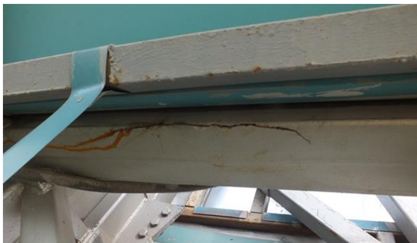
а – несоответствие угла наклона стержней решетки в узлах требованиям [2, 3]; б – трещины в поясах ферм из-за некачественных сварных швов Рисунок 1 – Ошибки при конструировании ферм из ГСП
