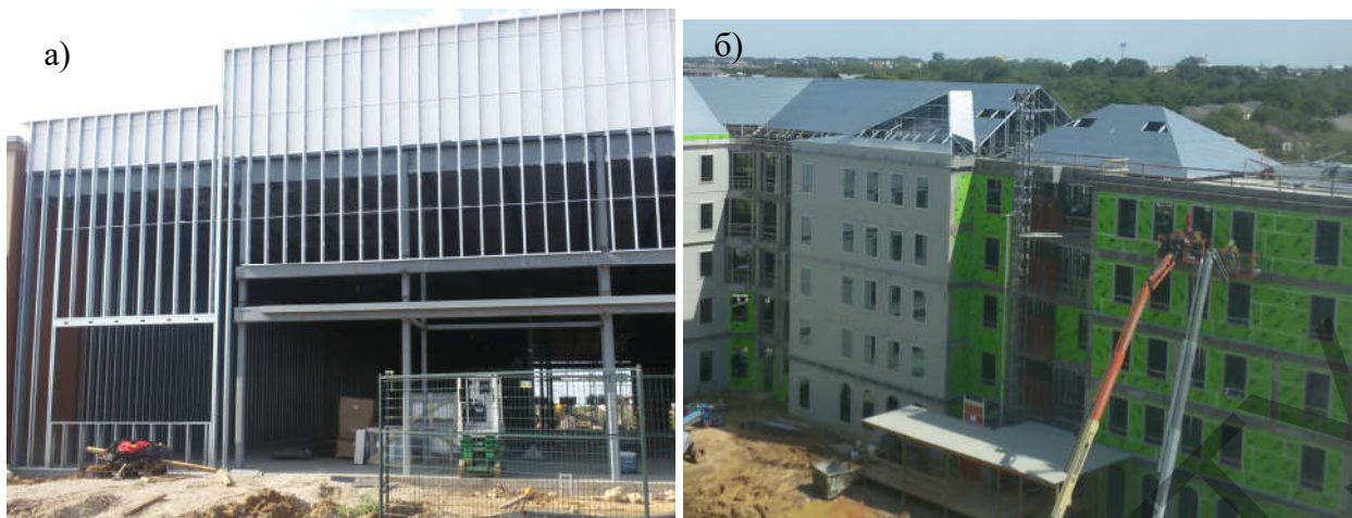
Рисунок 1 – Использование СТП на строительных объектах в г. Дентон (США, штат Техас) в августе 2018 г.: а) наружное ограждение торгового центра; б) стропильная система и ограждающие конструкции жилого здания
