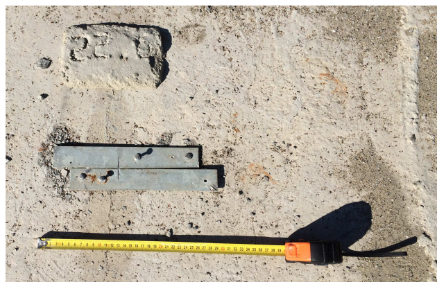
Рисунок 1 – Трещина в фундаментной плите хранилища. Маяк над трещиной
