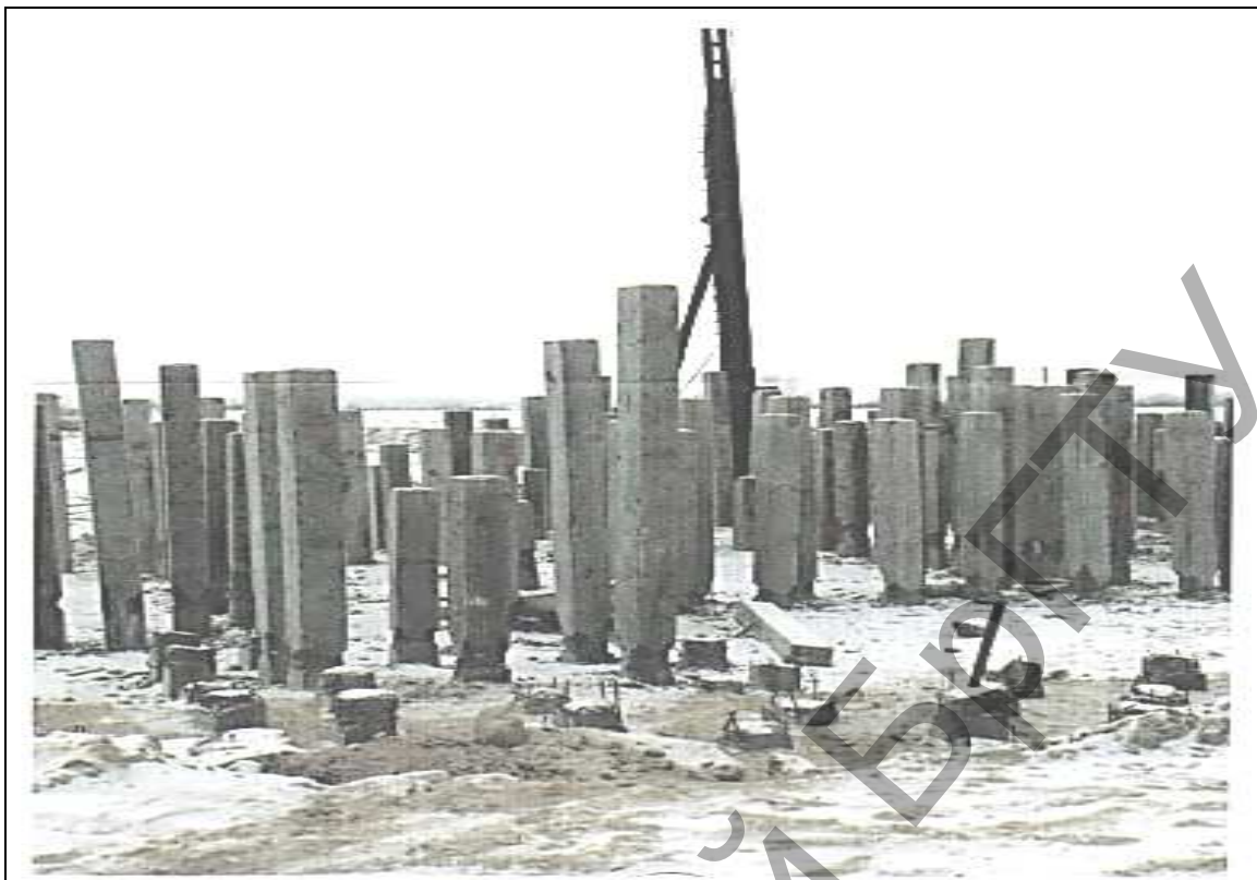
Рисунок 6 – Общие виды свайных полей на строительных площадках в застраиваемых микрорайонах г. Бреста
