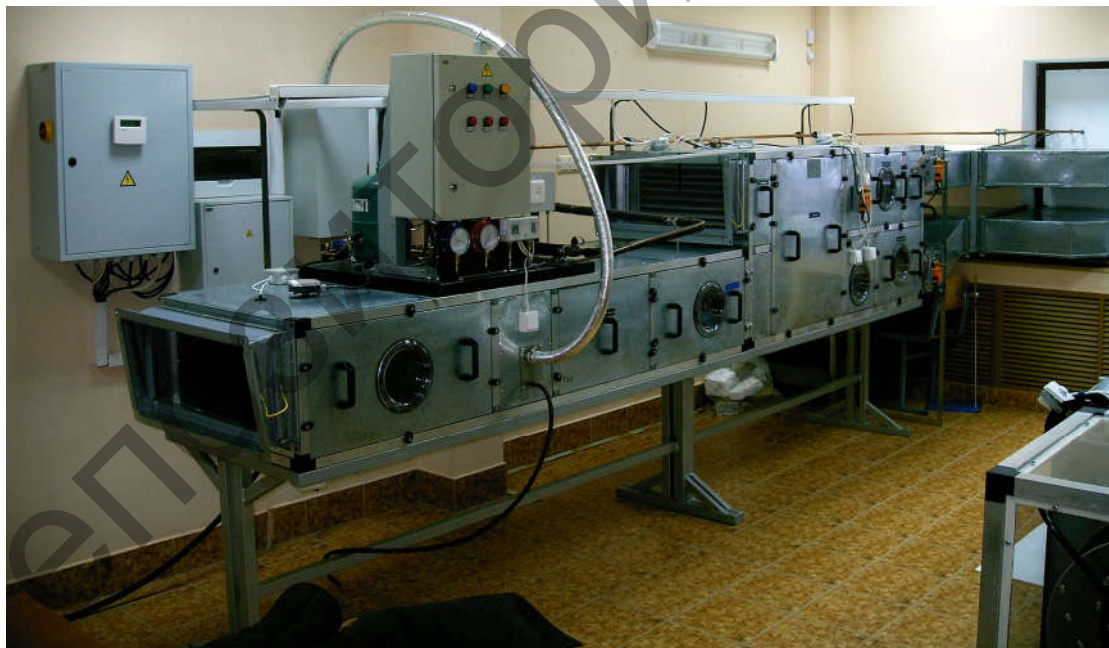
Рисунок 6 – Стенд “Центральный промышленный кондиционер” лаборатории “Кондиционирование воздуха и холодоснабжение”
