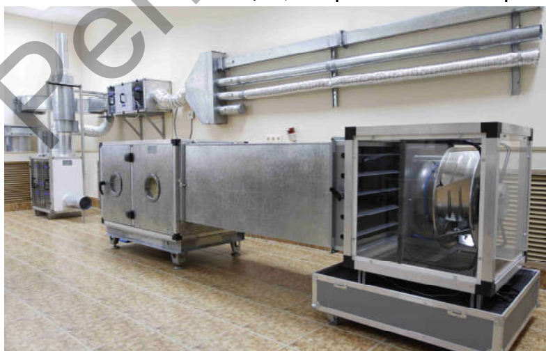
Рисунок 1 – Часть стендов лаборатории “Вентиляция”
