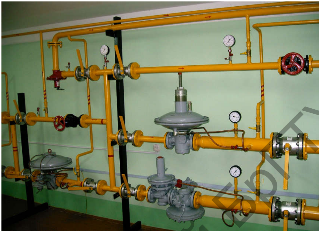
Рисунок 5 – Стенд “Газорегуляторная установка” лаборатории “Газоснабжение”
