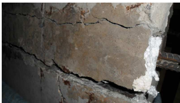
Рисунок 7 – Отрыв бокового ребра на третьей стадии работы диска перекрытия. Полное выделение балки поперечного направления
