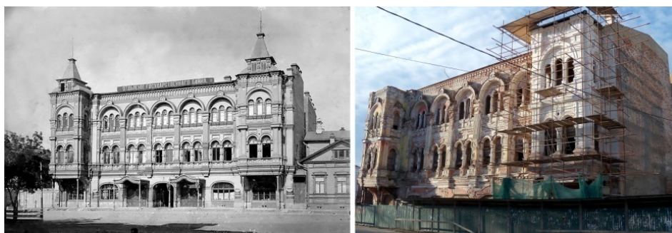
Рисунок 1 – Две из 22-х исходных фотографий объекта конкурса: начала 20 века (слева) и реставрируемого в настоящее время здания (справа)
