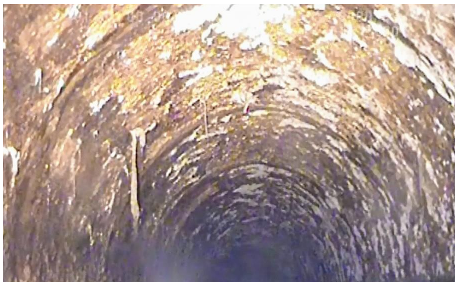
Рисунок 1 – Разрушенный трубопровод сети водоотведения
