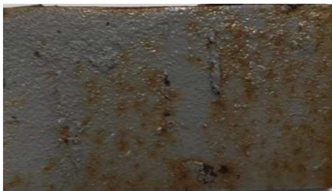
Рисунок 3 – Покрытия, нанесенные на неподготовленную поверхность
