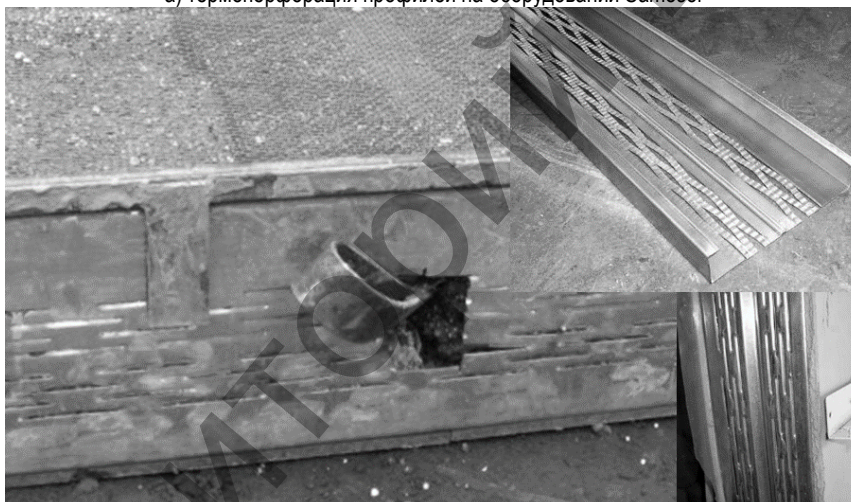
б) «белая» коррозия цинкового покрытия; деформация в виде «чешуи», «прорубки» стенки профиля без восстановления защитного цинкового покрытия у ряда российских производителей
