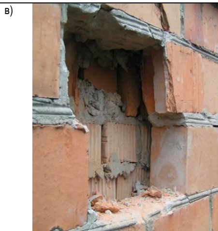
Рис. 2. Отслоение облицовочного слоя кладки наружных стен жилых домов
