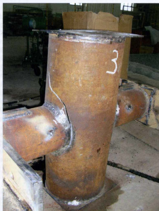
Рис. 8. Диаграммы деформирования узлов крепления подвесок к затяжкам арок (а) и характер их разрушения при растяжении узла (б).
