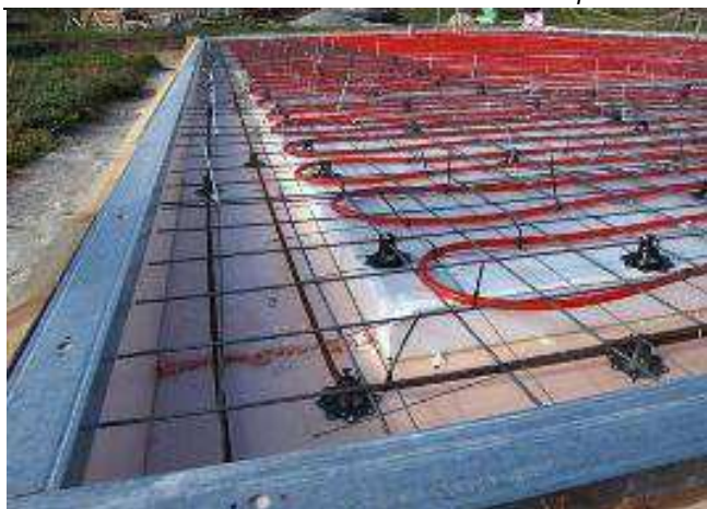
1 – монолитная бетонная плита; 2 – гидроизоляция (геотекстиль); 3 – теплоизоляция (плитный полистирол); 4 – система отопления (трубы водяного отопления)
