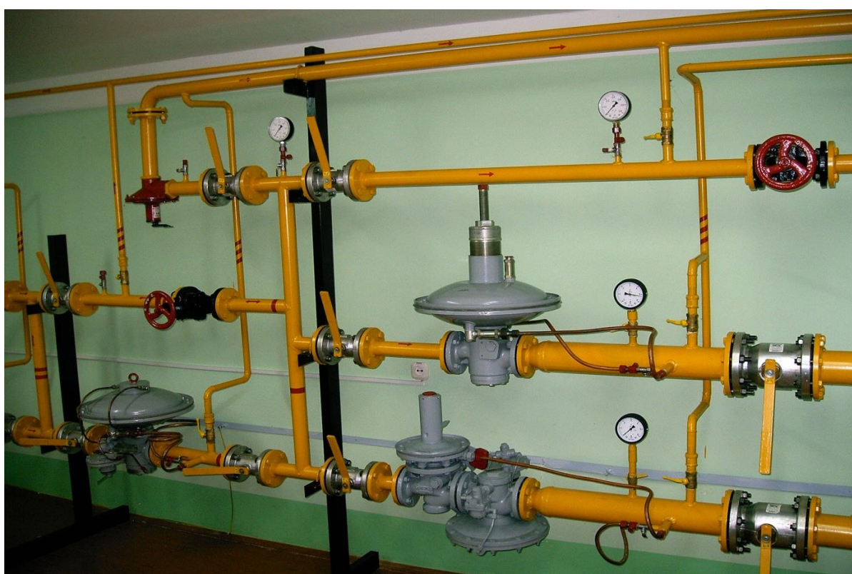
Рисунок 8 – Стенд “Газорегуляторная установка” лаборатории газоснабжение
