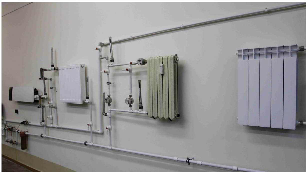
Рисунок 6 – Стенд “Система отопления” с различными отопительными приборами
