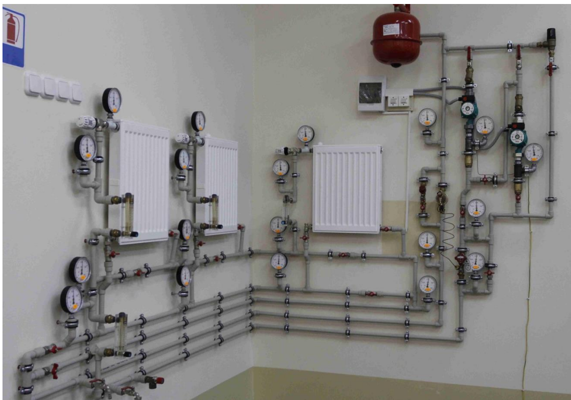
Рисунок 7 – Стенд “Балансировка современных систем отопления”
