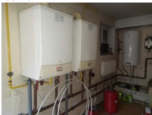
а) котельная 100 кВт;
