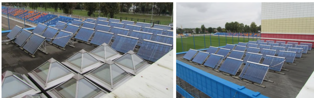
Рисунок 1 – Гелиоколлекторы на крыше здания стадиона «Локомотив» в г. Гомеле
