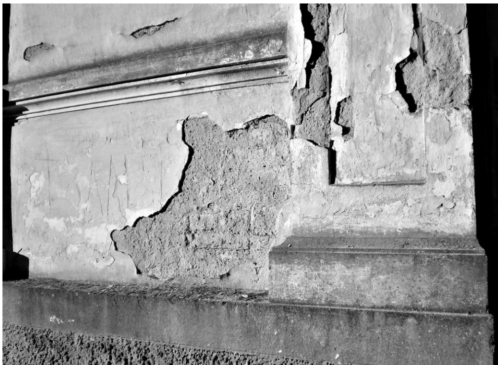
Фото 1 – Штукатурка, отколовшаяся от цоколя здания вследствие кристаллизации солей
