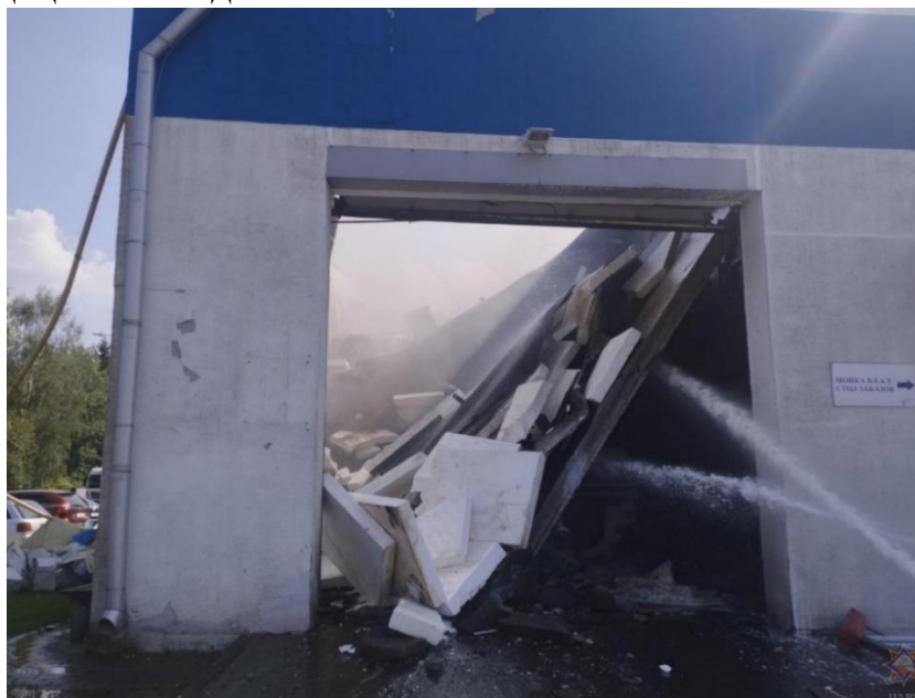
Рисунок 1 – Вид повреждений здания при дегазации транспортной емкости сжиженного газа при взрыве газовой смеси [3]
