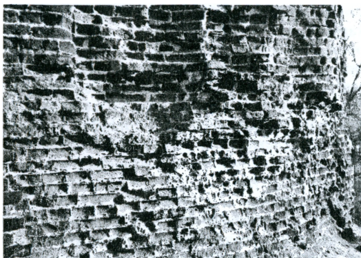
Рисунок 2 – Коррозионное разрушение кирпичной кладки вследствие сильного увлажнения и засоленности
