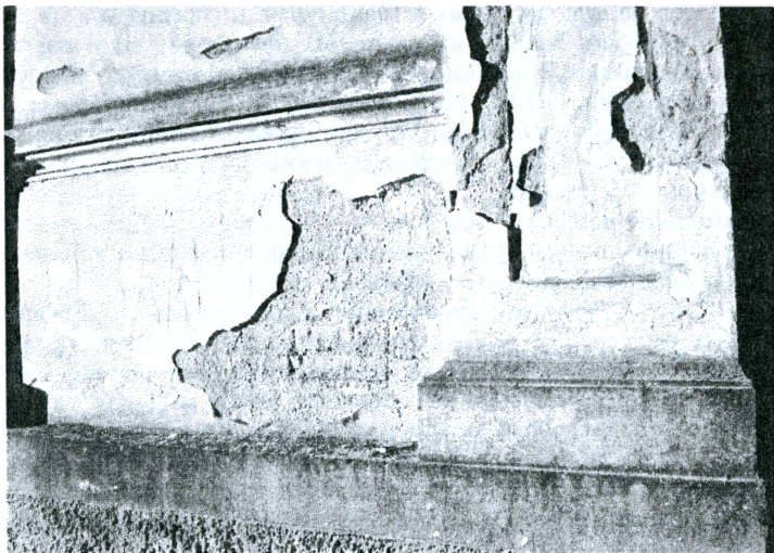
Рисунок 1 – Штукатурка, отколовшаяся от цоколя здания вследствие кристаллизации солей (пример коррозионного действия капиллярно поднимающейся влаги в сочетании с сильными высолами)
