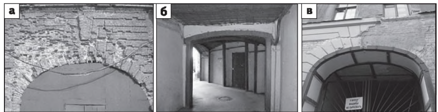
Рис. 2. Деградация каменной кладки над аркой (а), усиление арок металлическим обрамлением (б, в)
