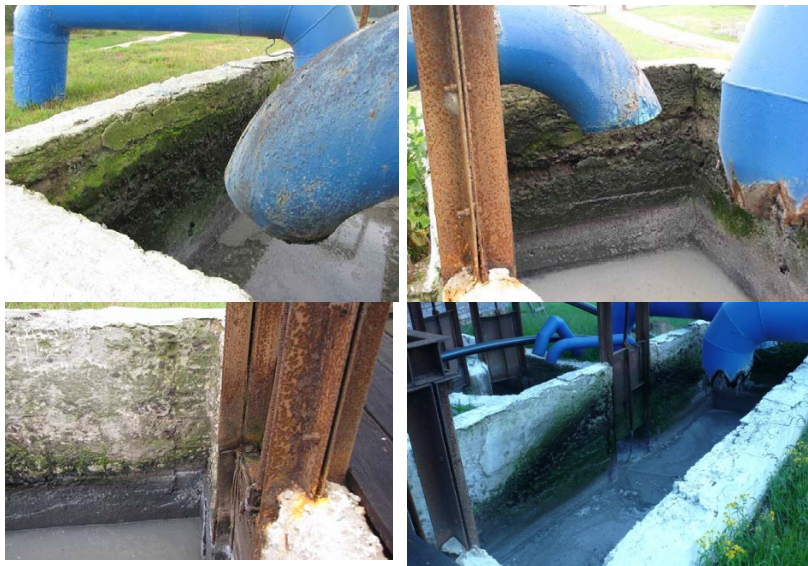
Рис. 4.2. Техническое состояние приемной камеры
