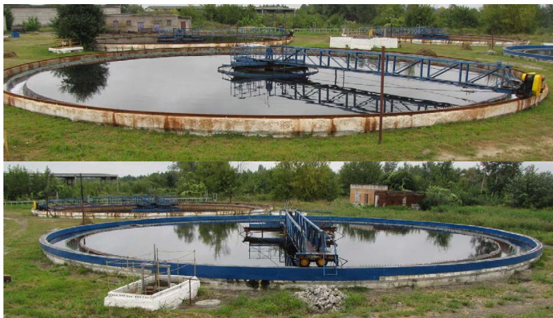
Рис. 4.11. Общий вид вторичных радиальных канализационных отстойников №1–6 КПУП «Брестводоканал»
