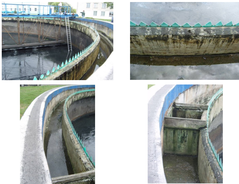
Рис. 4.14. Общий вид и конструктивное решение водосборных лотков отстойников № 1 и № 2
