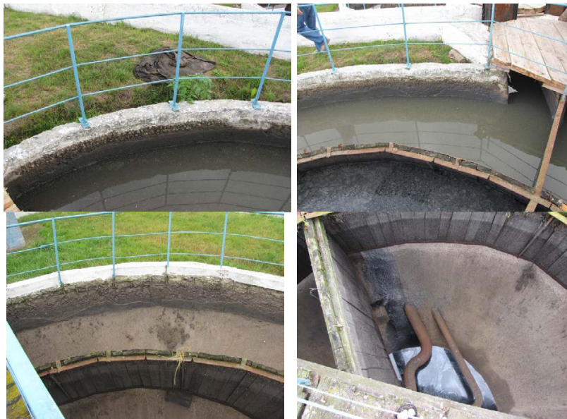
Рис. 4.4. Техническое состояние песколовок
