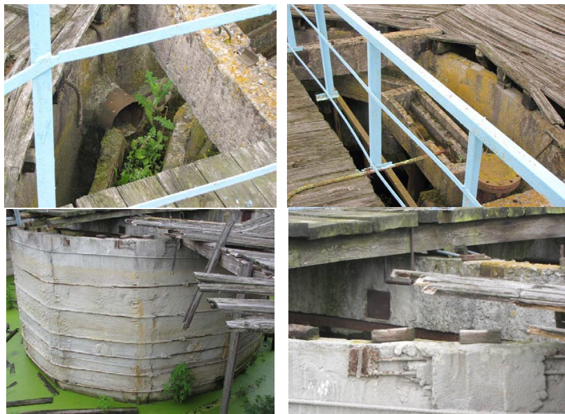
Рис. 4.8. Техническое состояние осветлителей-перегнивателей
