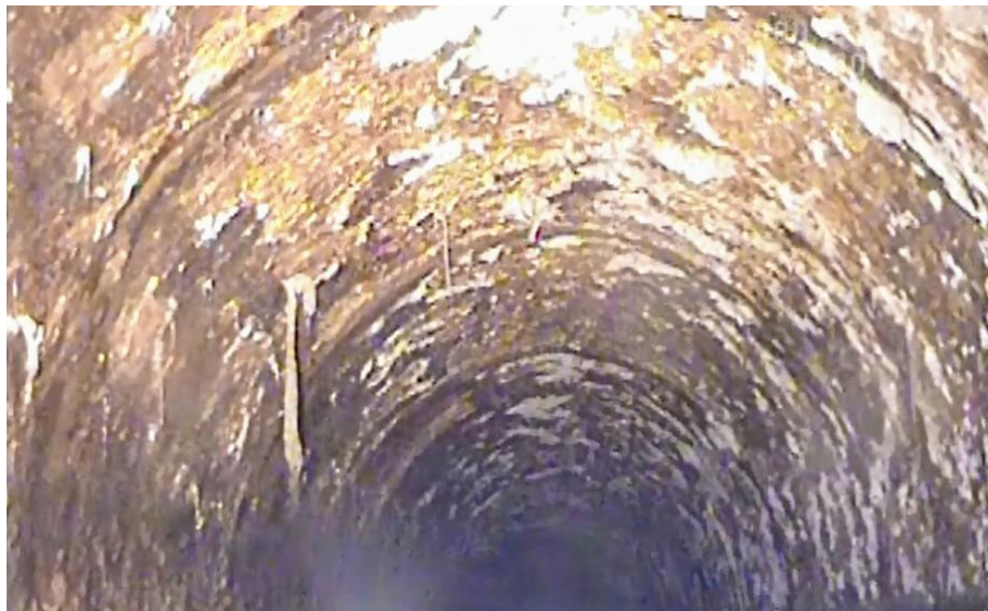
Рисунок 1 – Разрушенный трубопровод сети водоотведения
