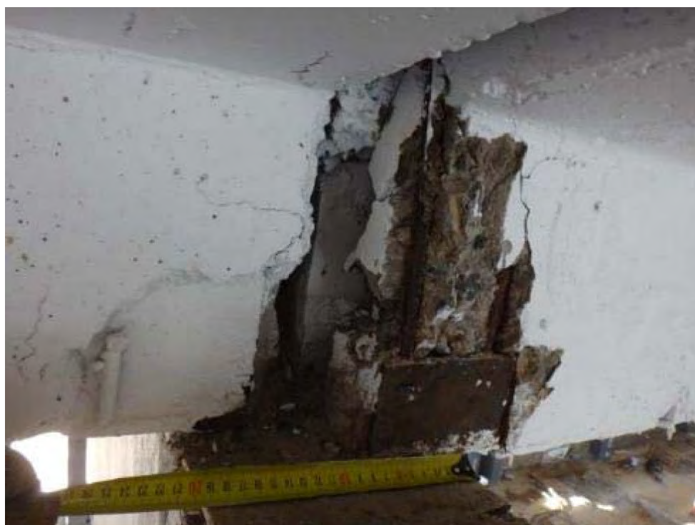
Рис.3. Разрушение опорной части ребристых плит покрытия
