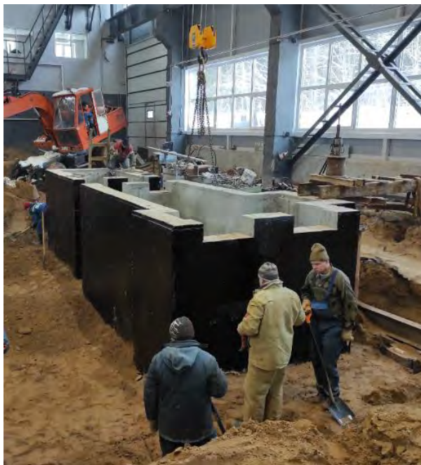
Рис.4. Общий вид фундамента под оборудование после завершения монолитных работ и частичной засыпки котлована
